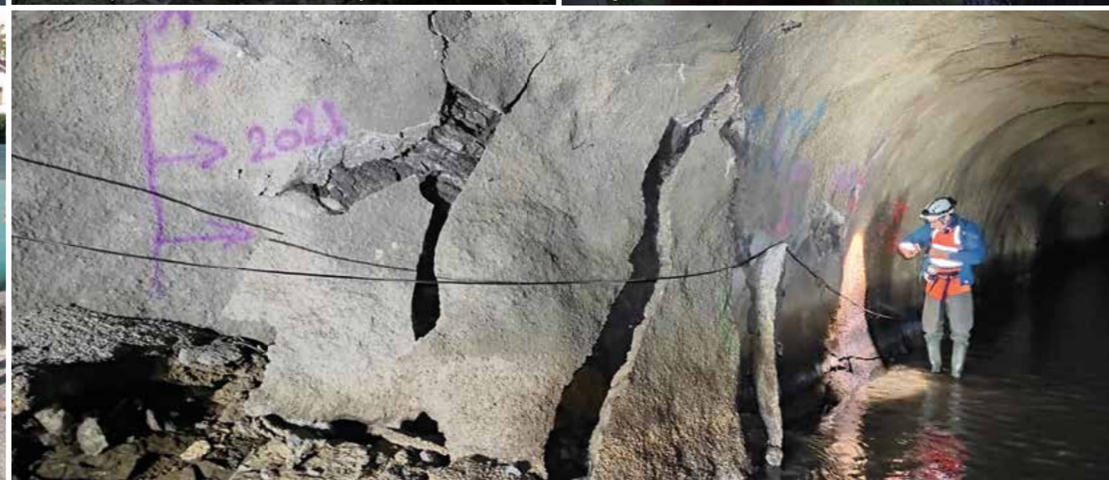
Caractérisation des dégradations du génie civil de la galerie de rejet au Rhône
